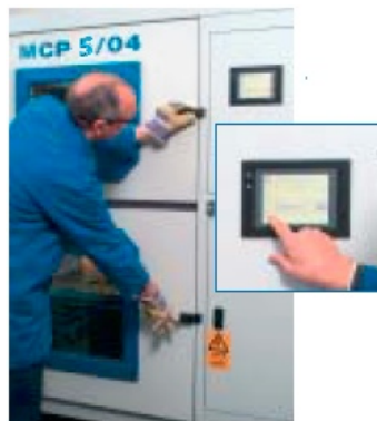
4 ドアを閉め PLC による自動制御
